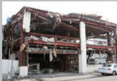
①女川支店 三陸沿岸の地域には、高さ10m以上の大津波が押し寄せ、町全体が流出する壊滅的な被害となった。当行支店も建物外枠のみを残し、全てが流出・全壊した。
